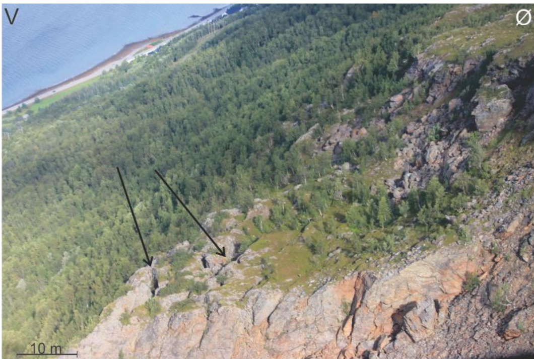
Figur 83. Ustabilt fjellparti ved Skredan. Vest-øst strykende sprekkeseett avgrenset partiet i en skrent i bunn av bildet. Sprekkeseett i NØ-SV og NV-SØ retning har åpnet flere store sprekker (piler) i den ustabile blokken. Foto: Eirik Bjørklid, modifisert til oppgaven
