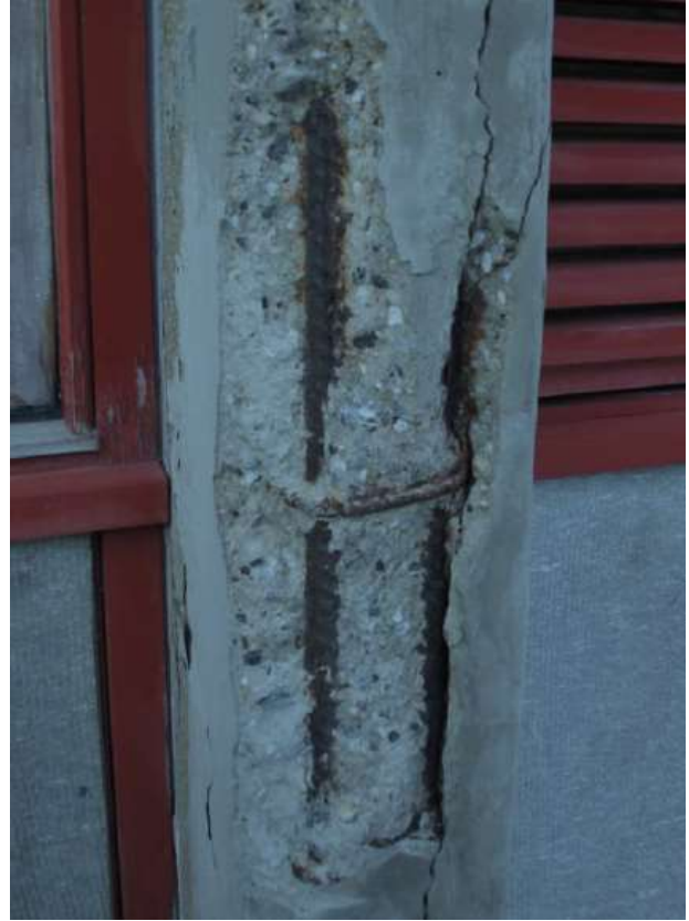
Figur 1. Skadet søyle plan 3 østfasade.
