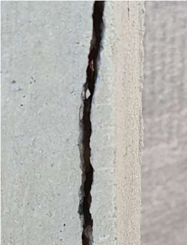
Figur 2. Skadet søyle plan 3 sørfasade.
