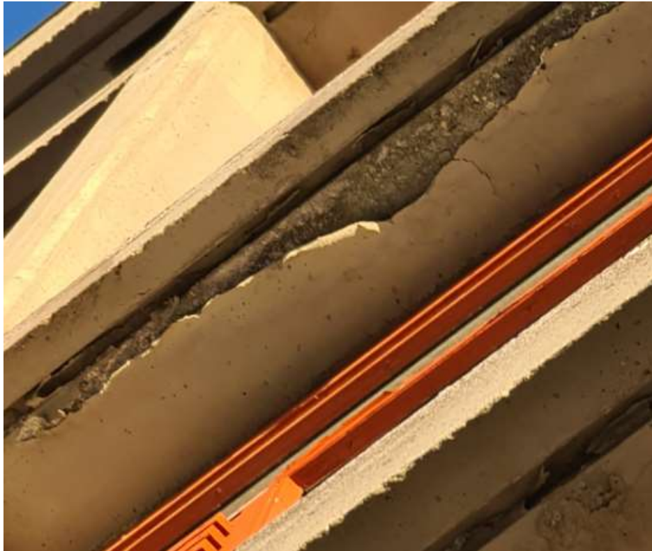
Figur 27. Krakelert puss under dekkeforkanter plan 6 vestfasade.
