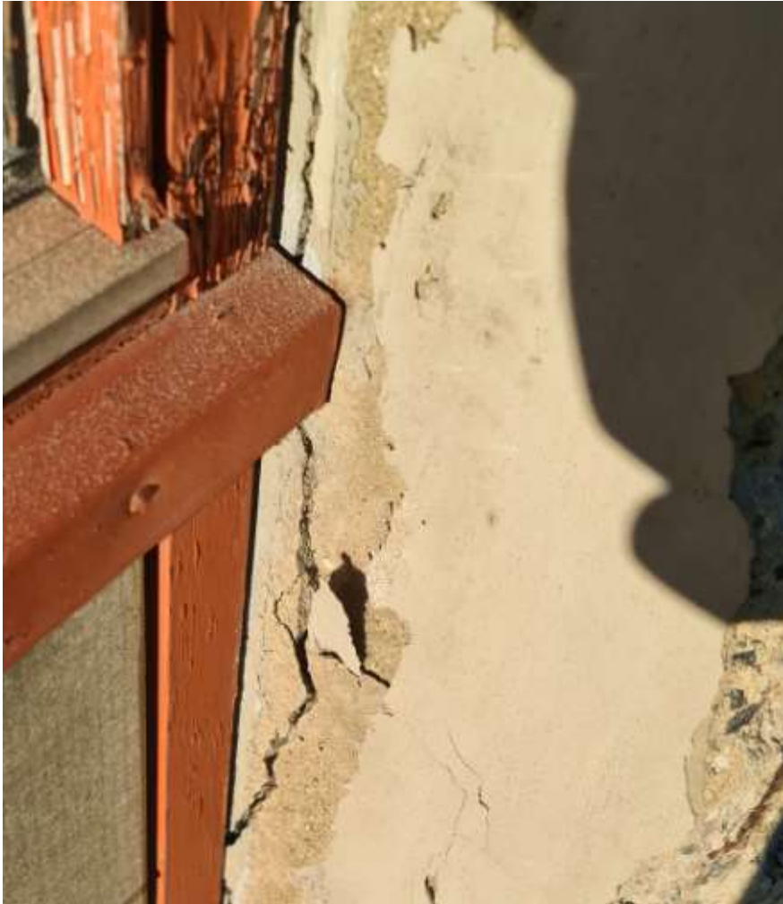
Figur 24. Sprekk i bakkant av søyle fra figur 22 og 23.
