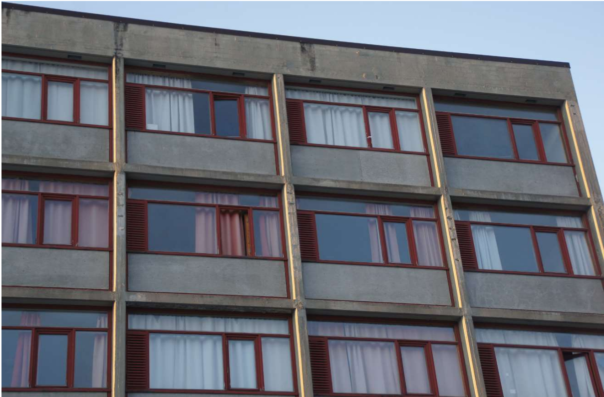
Figur 21. Manglende overdekning på bøyler i plan 6 østfasade.
