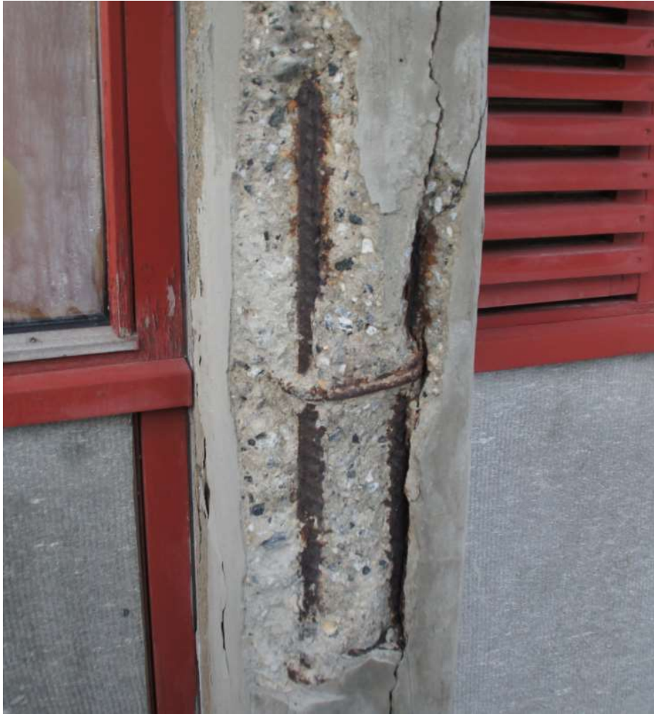
Figur 22. Avskallet betong med eksponert og korrodert armering i plan 3.
