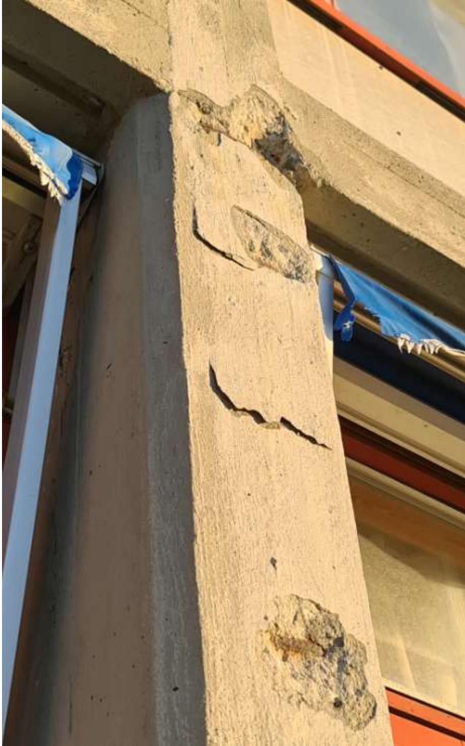
Figur 26. Krakelert puss og manglende overdekning på bøylar i vestfasade plan 1.
