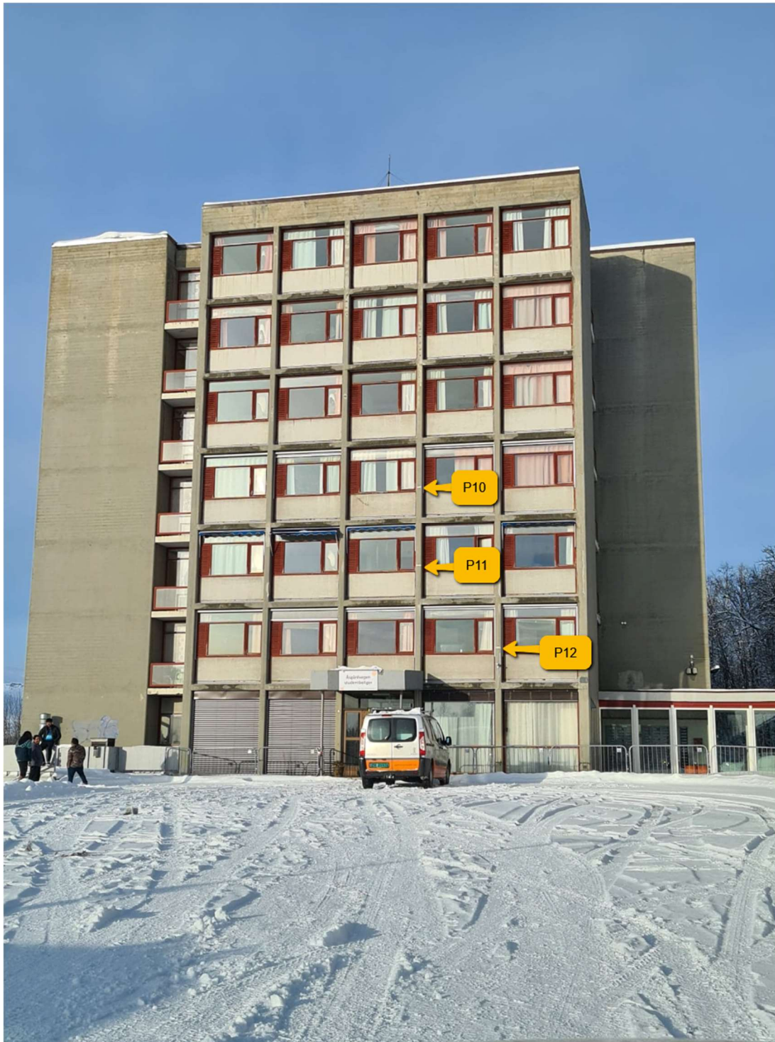
Figur 35. Prøvehull P10-P12 sørfasade.
