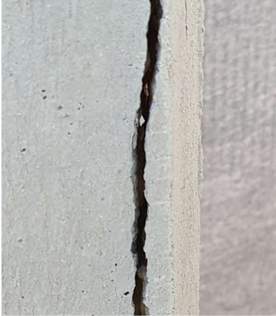
Figur 28. Viser sprekk tvers gjennom betongsøylen over inngangspart ved sørfasaden.
