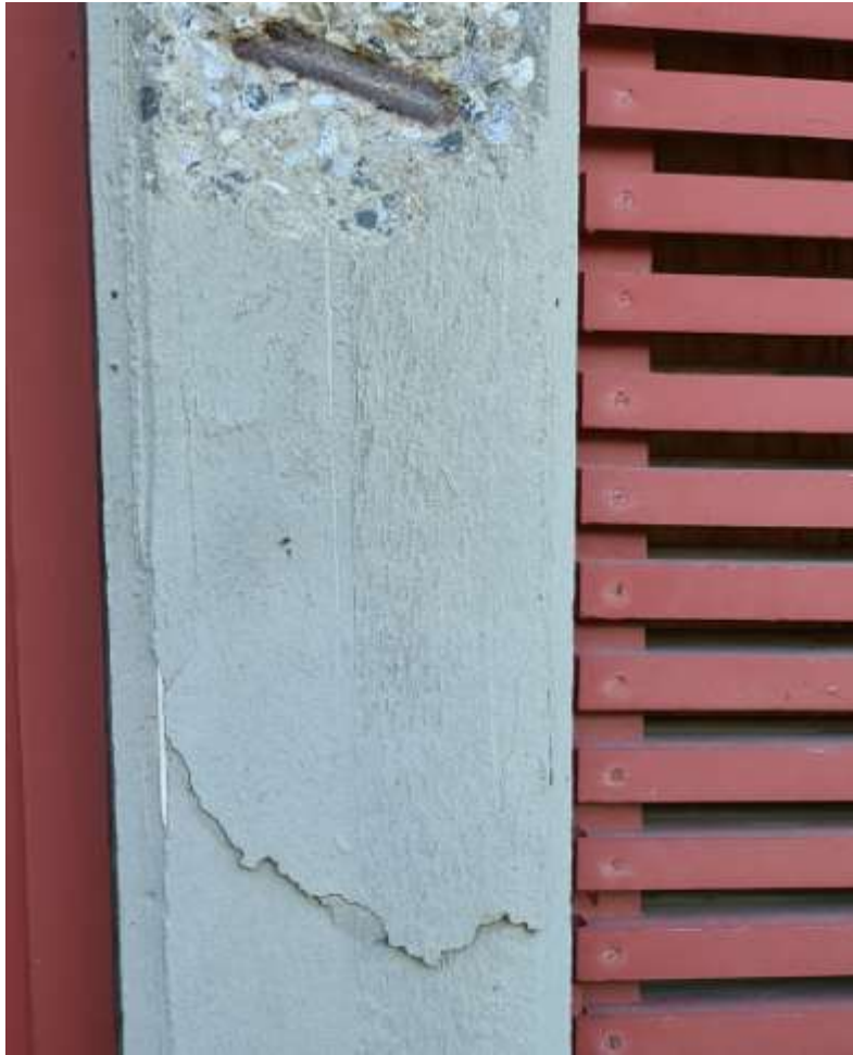
Figur 25. Krakelert puss og manglende overdekning.
