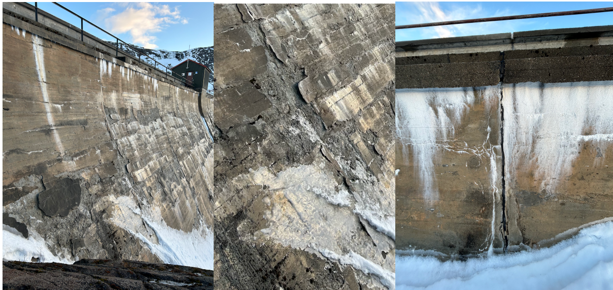
Figur 21. Kalkutslag på Jernvassdammen. (Foto: I.E.A.Hjallar, Feb, 2023)
