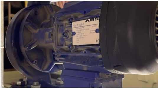
Pumpe tur varmebatteri
