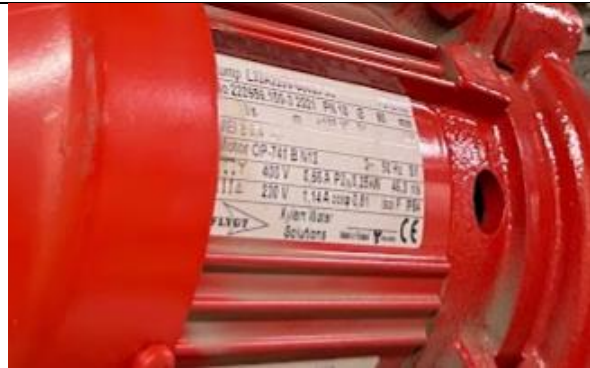
Pumpe retur varmebatteri
