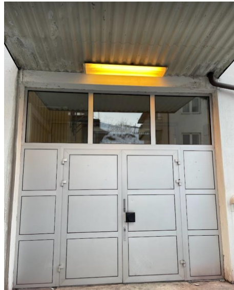
Sekundær-inngang fasade øst
