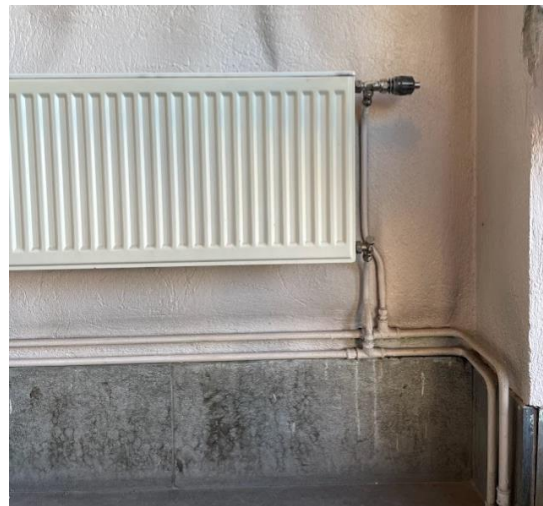
Radiator trappegang nord
