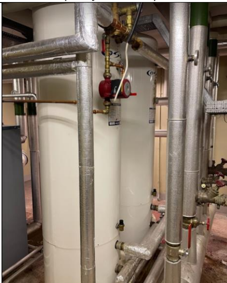
Fordelerstokk og parallellkoblet VVB
