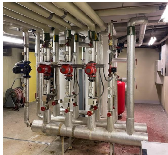
Fordelerstokk radiator og varmebatteri
