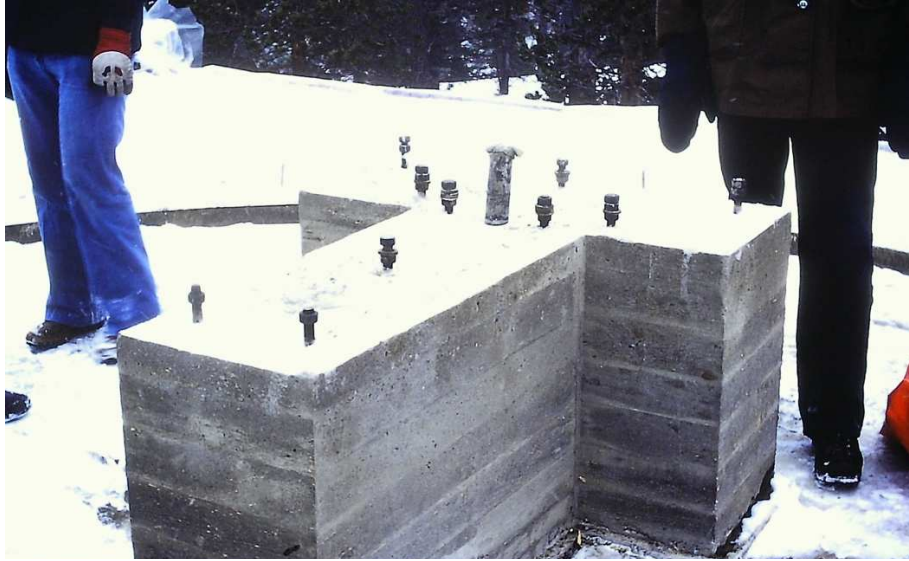
Figur 3.9. Nå er observasjonstaket og teleskopfundamentet ferdig. I fundamentet er det støpt ned bolter etter oppgitt mønster for teleskopets fot. Plastrøret er for styringskabler som skal inn i teleskopfoten. I bakgrunnen ser vi skyggen av en ring hvor kuppel skal festes. Foto: JES
