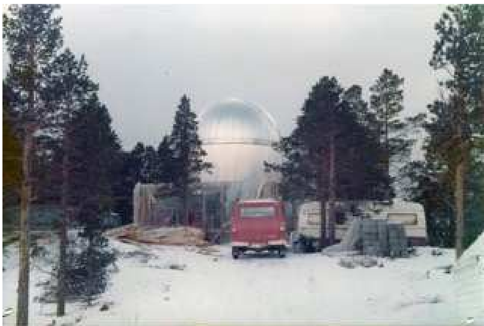
Figur 3.12. Observatoriet med Observasjonstak og kuppel – klart til å ta imot teleskopet. Huset er under bygging under plasten. Mars 1977. Foto: JES.
