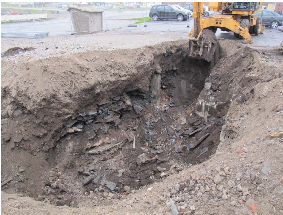
Figur 4 I den nordlige delen av sjakt 1 traff vi på tykke murte kjellervegger. Sjakta ble derfor dreid mot øst (sjakt 1a), men også her bestod undergrunnen av nyere bygningsrester
