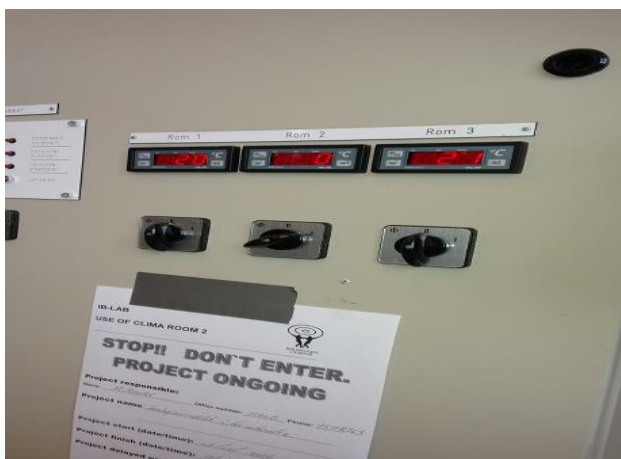
Figur 63. Temperaturens kontroll på laben
